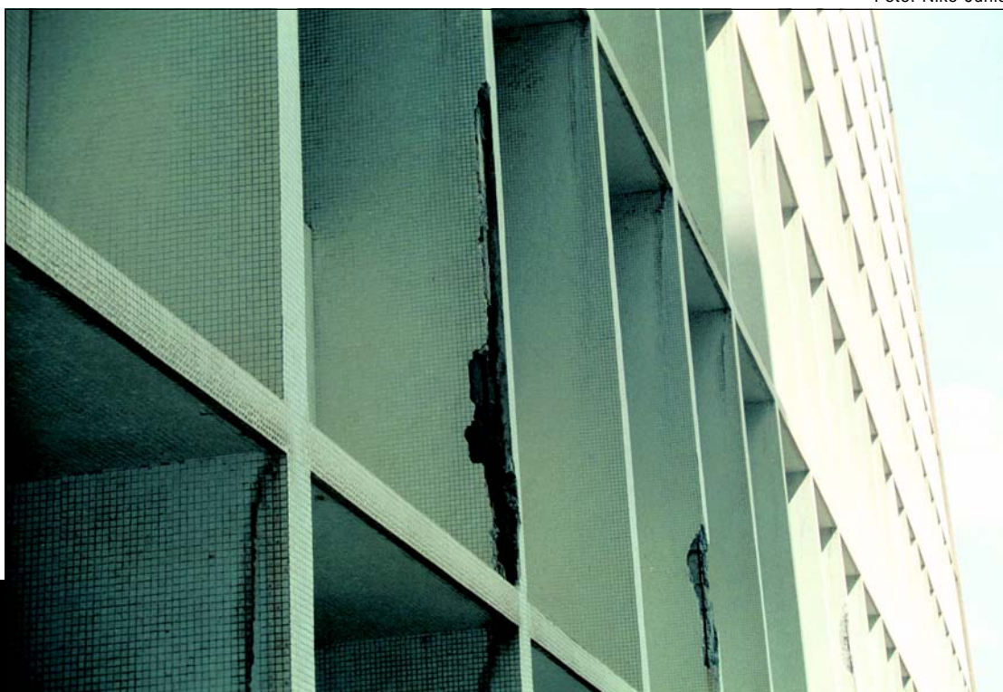
“PERNA SECA” . Essa parte do prédio do HU está comprometida
